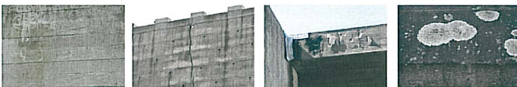
Anomalias em estruturas.
