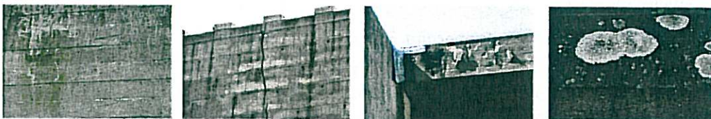
Anomalias em estruturas.
